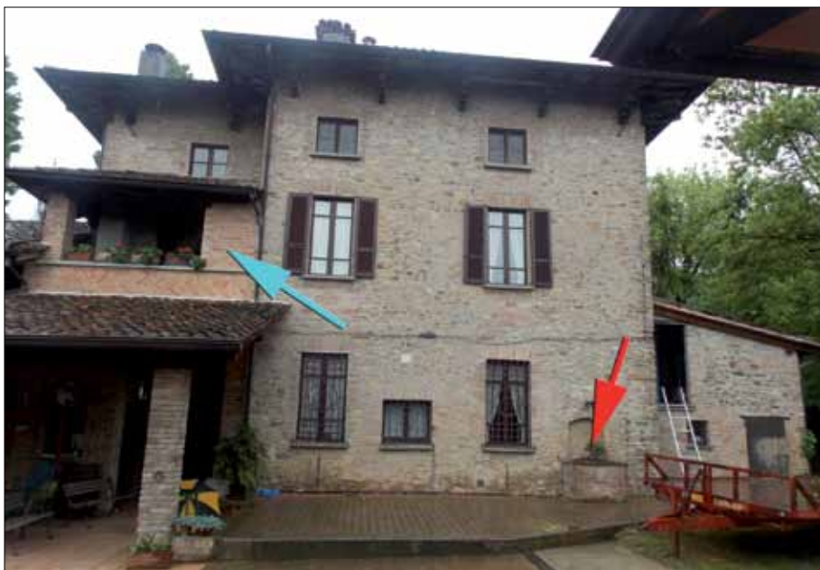
Fig. 15: L'edificio visto da nord. La freccia rossa indica il pozzo: è forse quello nominato nel rogito Gravaghi del 1870?. La freccia azzurra indica invece una struttura costruita nella prima metà del XX secolo, con mattoni inseriti a spina di pesce. La collocazione dei mattoni in questo modo è principalmente eseguita con intenti decorativi, ed è ampiamente visibile in edifici ristrutturati o realizzati in stile neomedievale a Castell'Arquato e dintorni.
